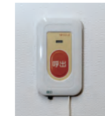
浴室緊急通報装置
